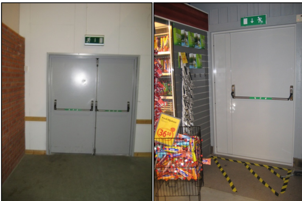
Figur 4.3. Exempel på två av de trasiga skyltar som uppmärksammades under platsbesöket.
