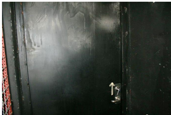
Figur 27: Dörrbeslag till utrymningsväg från scenen.
