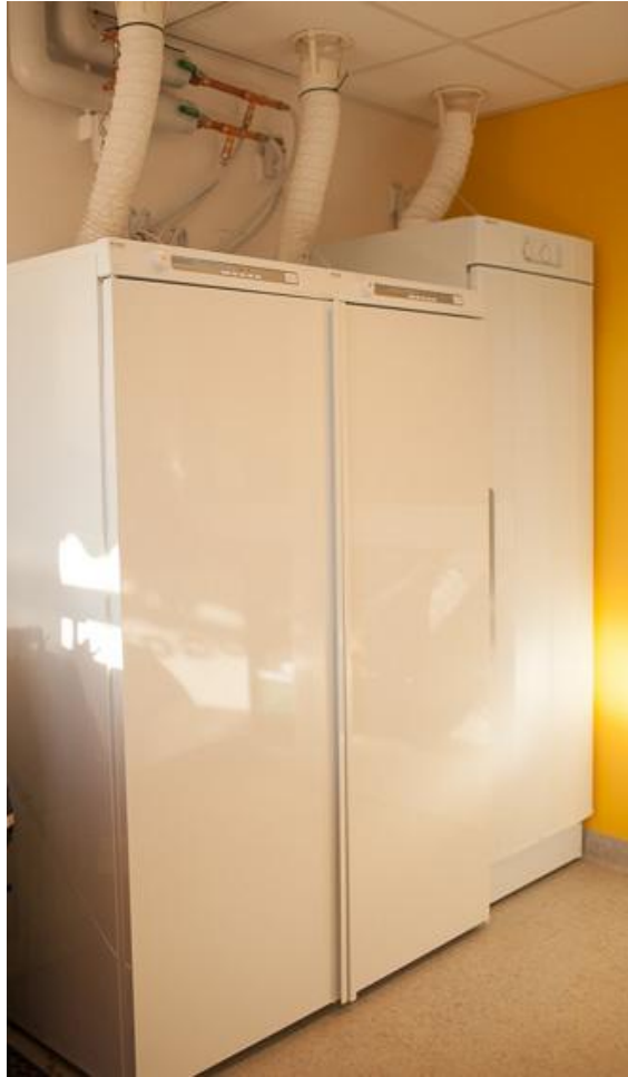
Figur 7 Två värmedrivna torkskåp installerade på Rösegårdsskolans förskola i Västerås. Det enda som tyder på att skåpen är värmedrivna är kopparrören som ansluter till fjärrvärmesystemet. [36]
