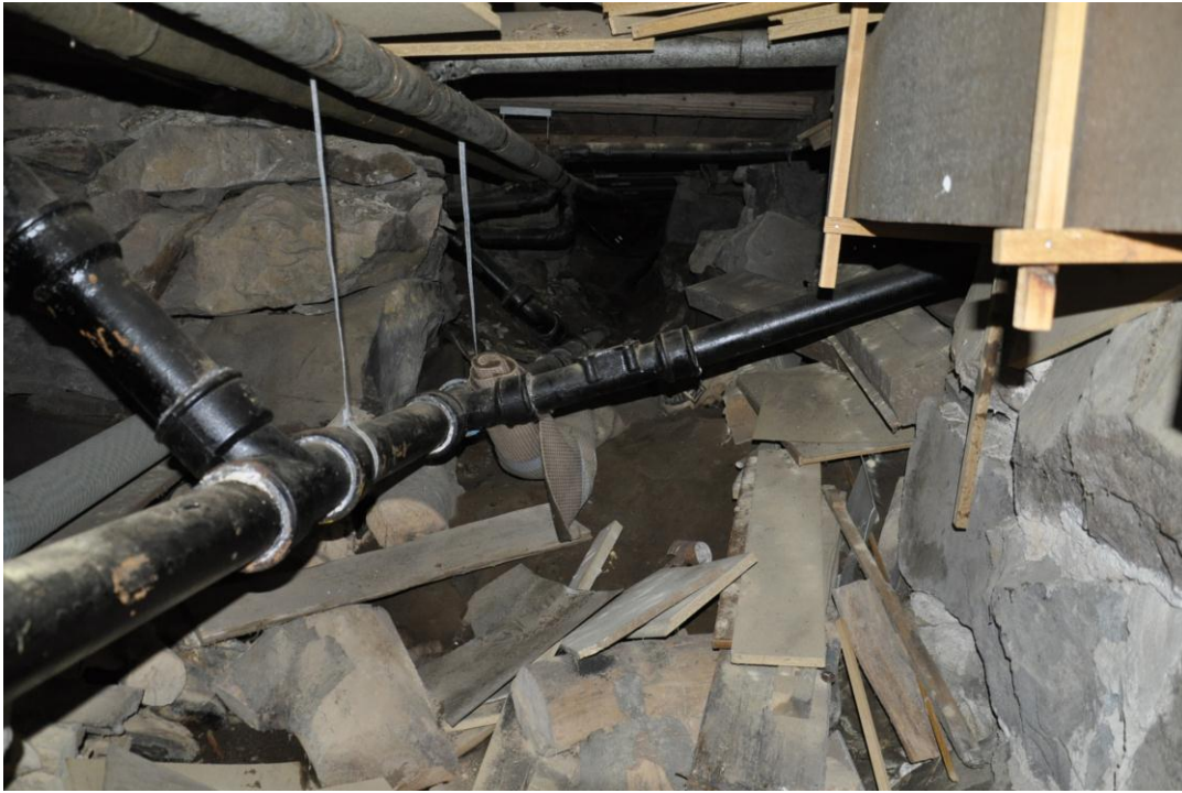
Figur 6: (C) Hanna Svensson Krypgrund med organiskt material i hus 3.
