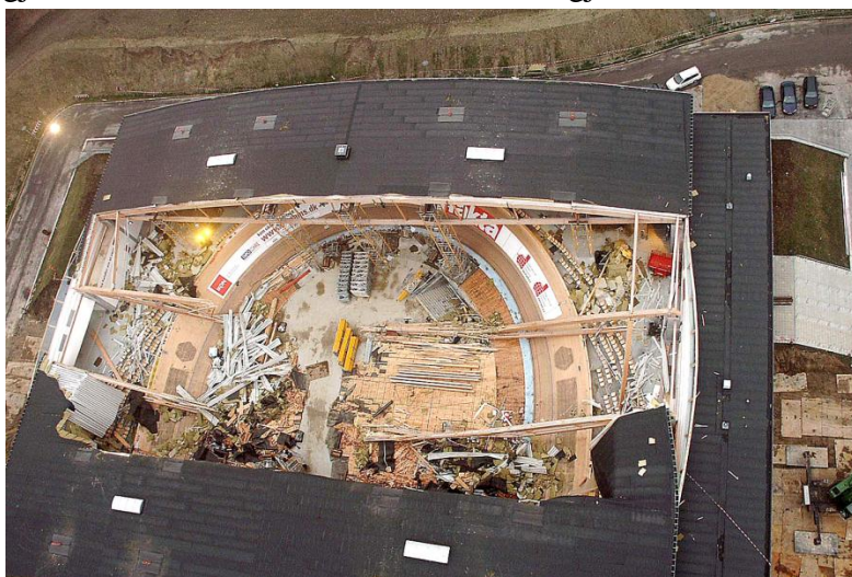
Figur 3.6 - Kollapsen av taket i Ballerup Arena, (Frühwald et al., 2007)
