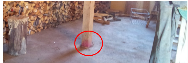
Fig. 7. Den röda cirkeln visar röda fläckar runt en pälle där betningsmaskinen stått, golvet runt f.d. betningsmaskinen är också svagt rödfärgat, men har sugits ner i betonggolvet och nöts bort en del (Foto: Michelle Karlsson, 2013).
