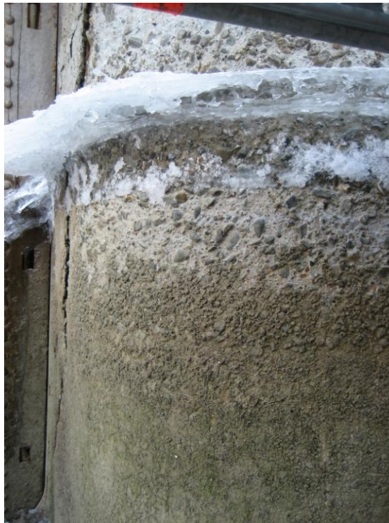
Figur 2.1 - Skador på betong i nivå med vattenytan (Rosenqvist 2013).
