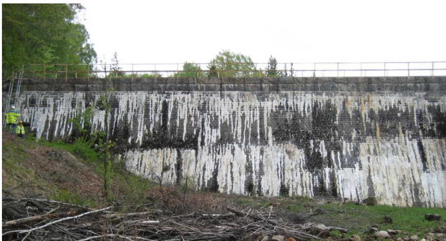
Figur 3.12 - Nedströmssidan hos en äldre dammkonstruktion som drabbats av omfattande urlakning (Rosenqvist 2013).
