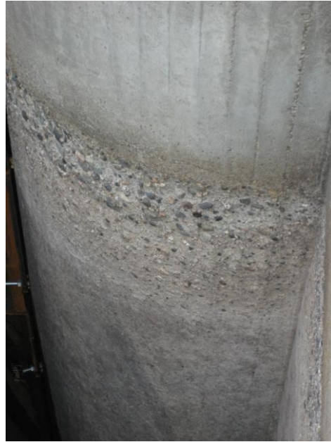
Figur 2.3 - Närbild på avskalningar längs vattenlinjen på uppströmssidan (Rosenqvist 2013).
