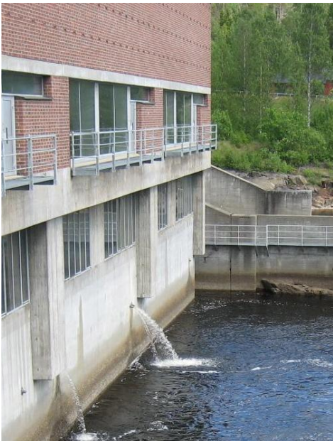
Figur 2.4 - Avskalning av täckskikt på nedströmssidan (Rosenqvist 2013).
