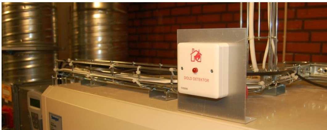
Bild 5 – Dold detektor finns installerade i ventilationen.
