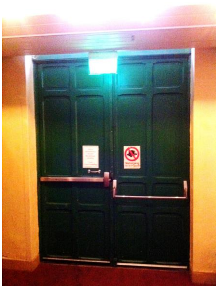
Figur 17. Utrymningsdörr med olika panikbeslag.
