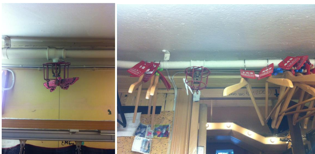
Figur 15. Hinder för sprinklerhuvuden i garderoben.
