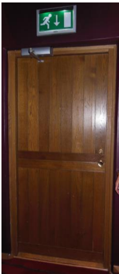
Figur 28. Bild från platsbesök över dörr i stora teatern med problematisk låsvred
