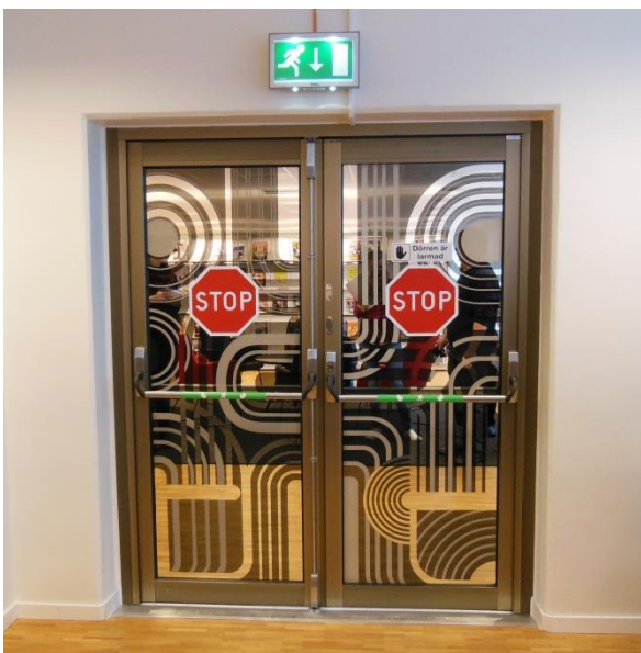
Figur 32. Bild från platsbesök över felaktigt skyltad utrymningsväg i biblioteket
