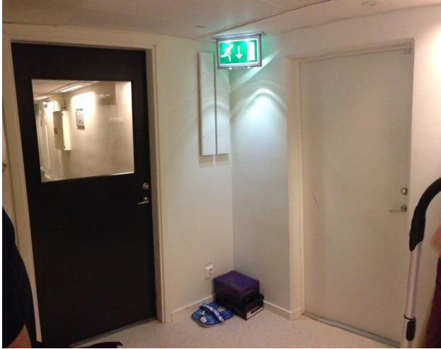
Figur 31. Bild från platsbesök över dåligt placerad utrymningsskylt
