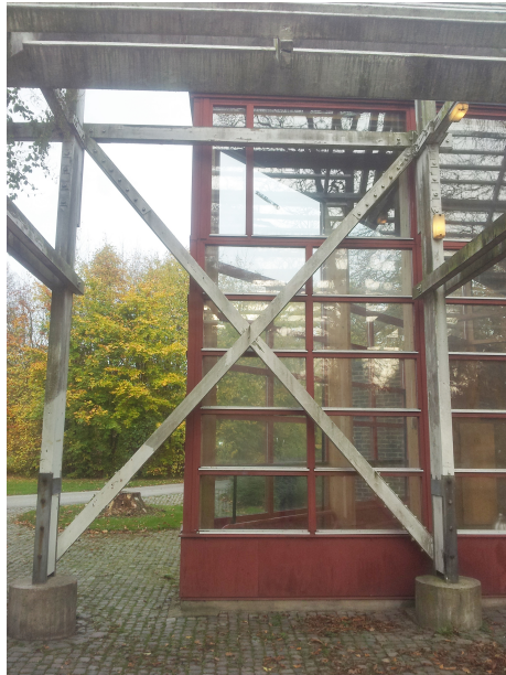
Figur 2.3: Dragkryss av trä i Folkets park i Lund. Dragkryssets strävor befinner sig i samma plan, därför görs urtag i mitten på strävorna.
