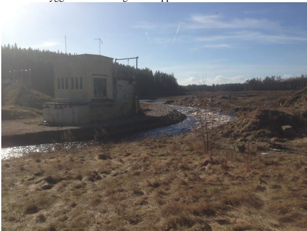
Kraftverksbyggnaden från nedsströmssidan. Till vänster syns delar av mittenvallen och utskovet vid höger dammvall. Till höger syns resterna av vänster dammvall.
