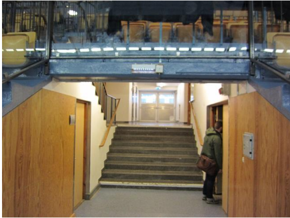
Figur 12. Utrymningsskylt saknas vid norra läktaren
