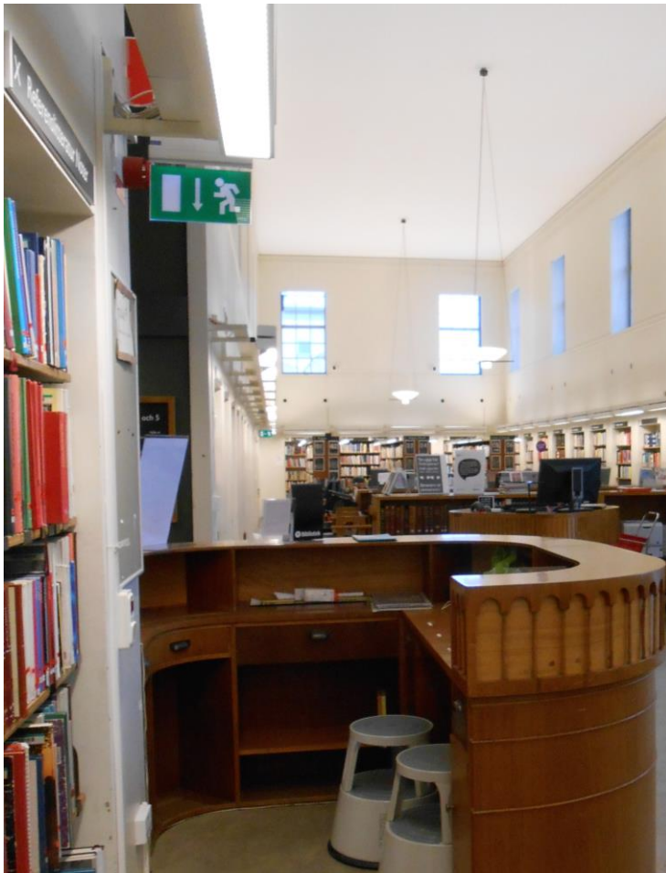
Figur 14. Missvisande utrymningsskylt utplacerad ovan passage till bokhall 301 i facksal 2 som ser ut att visa utrymning via bokhallen.
