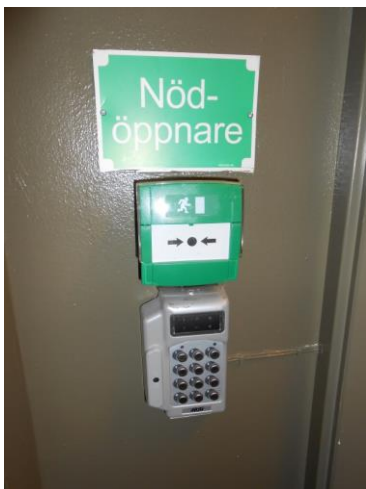
Figur 7. Nödöppnare som gör det möjligt för besökare att öppna och passera annars låsta dörrar vid utrymning.
