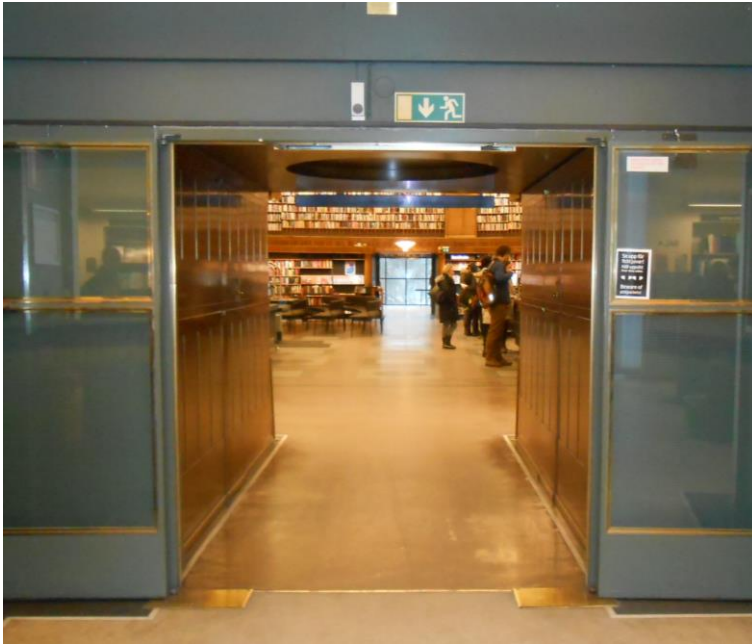
Figur 15. Olämpligt utplacerad utrymningsskylt ovan passage till bokhall 301 i facksal 2, där utrymning i enlighet med denna skyltning här sker åt båda hållen genom öppningen.
