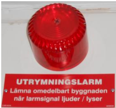
Figur 6. Larmdon, besökare och personal blir underrättade att de ska utrymma byggnaden genom att larmsignal ljuder och/ eller lyser samt att det finns beskrivande skyltar uppsatta. Denna anordning finns utsatt i offentliga delar av byggnaden.
