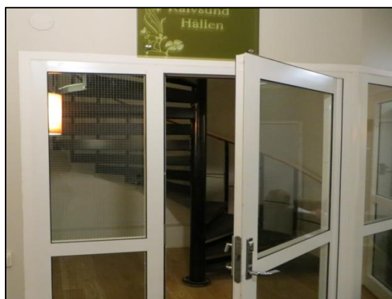
Figur 3-5 - Dörr som enligt ritning är brandklassad, något som ej kunde verifieras vid besöket.
