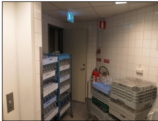
Figur 3-2 - En redan smal utrymningsväg är i stort sett blockerad.
