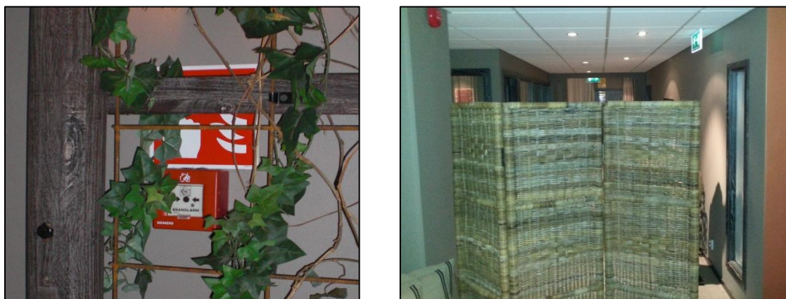
Figur 3-4 - Brister i brandskydd som har uppstått på grund av möblering vid spaavdelning
