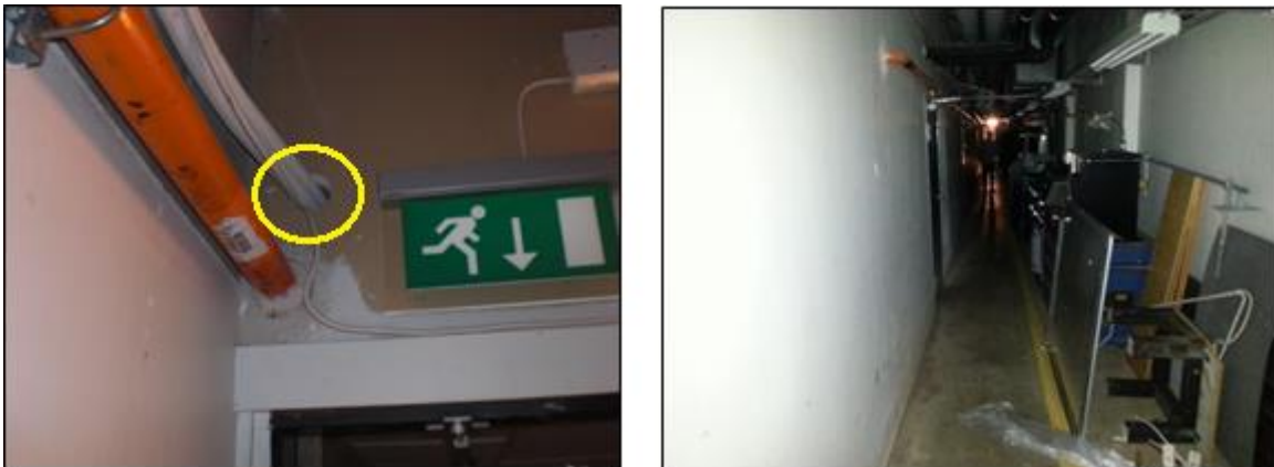
Figur 3-1 - Till vänster ses brister i genomföring i brandcellsgräns vid en av dörrarna i korridoren förbi bowlinghallens teknikrum. Till höger ses att korridoren dessutom är delvis blockerad.
