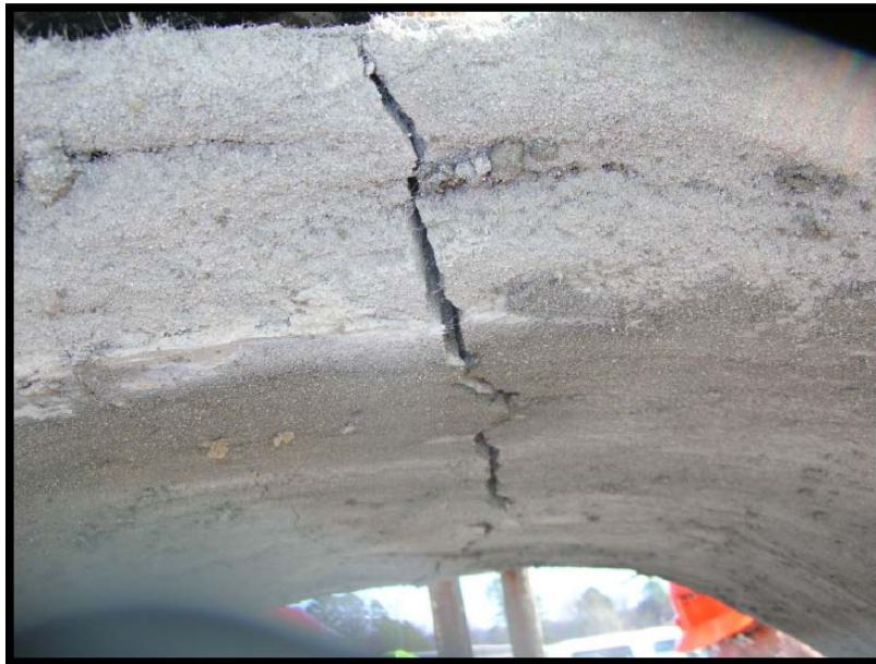
Figur 3 Sprickor i hjässan hos det förstärkta röret (Davidson, et al., 2008)
