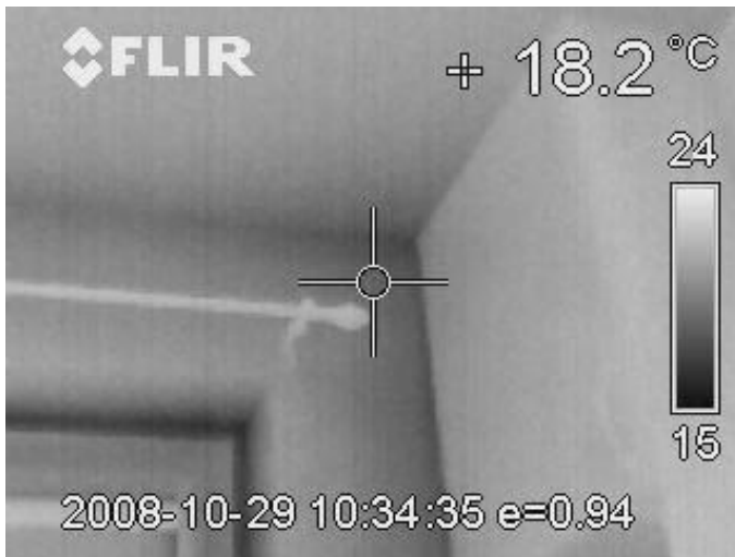
Bild 14 visar att anslutningen mellan innervägg och yttervägg är kallare än resten av väggarna, och dessutom att anslutningen mellan fönsterkarmen och fönsterbågen är kallare än omgivningen.
