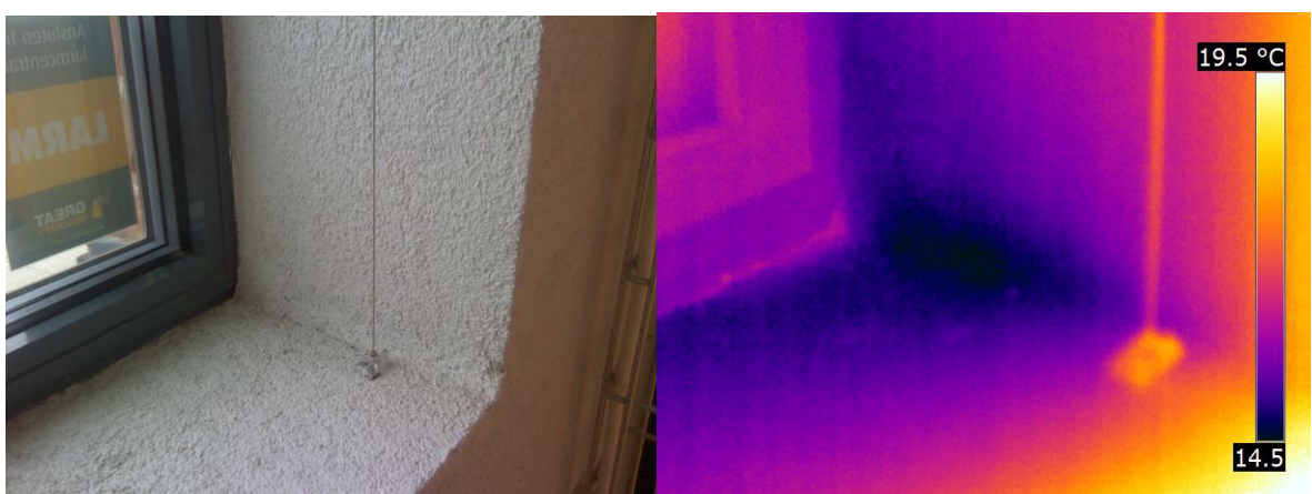
Figur 9.3: Otätheter kring fönster
