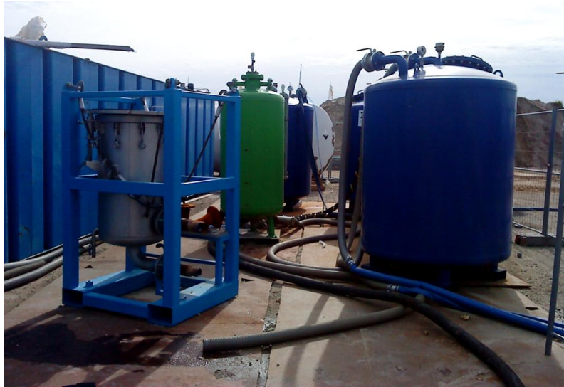
Figur 7-4. Reningsanläggning för TBT-förorenat vatten i Lomma Hamn.
