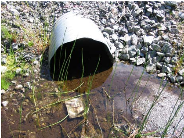
Bild 67: Väl miljöanpassad trumma vid bystråkets östra utkant. (1521797; 7051226)
