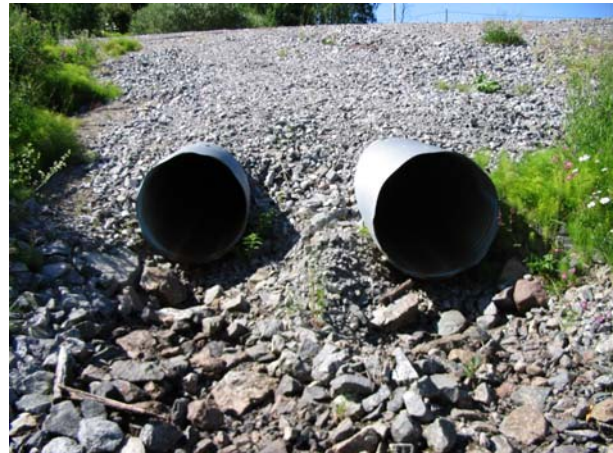
Bild 68: Dubbeltrumma inne i Vallen. Vattnet rinner genom väggkroppen istället för genom trummorna, som därför utgör ett definitivt vandringshinder. (1520297;7049613)
