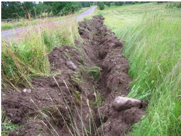
Bild 69. Nedgrävning av kabel i den södra vägläntan- delar av vegetationen bortgrävd i den södra vägläntan. 1438878;6780031
