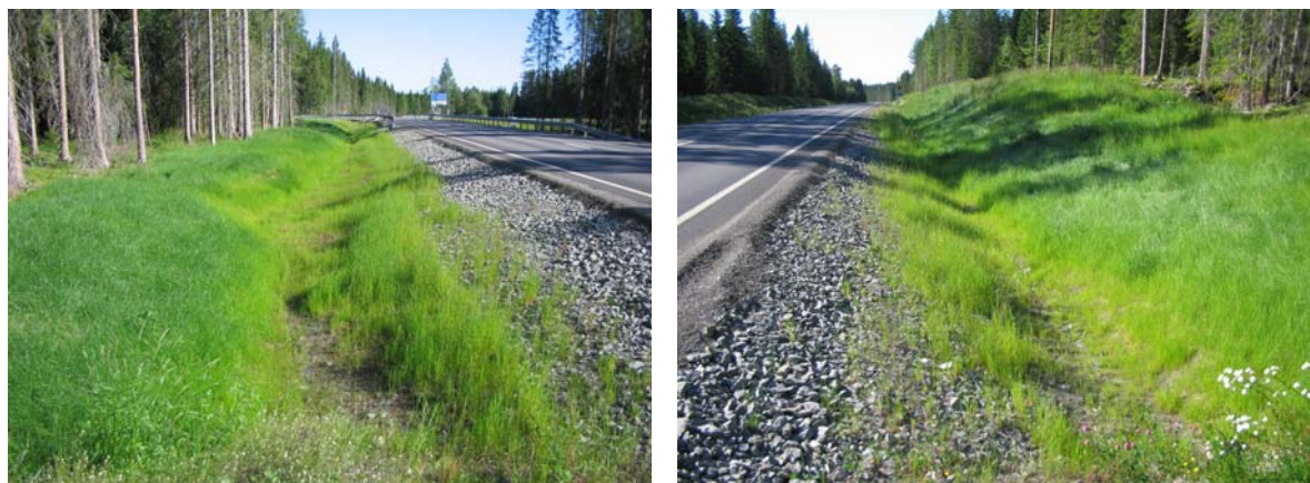
Bild 24. Gräs insått i vägkanterna på hela sträckan. (t.v.: foto mot norr, t.h.: foto mot söder 1424970;6979030)
