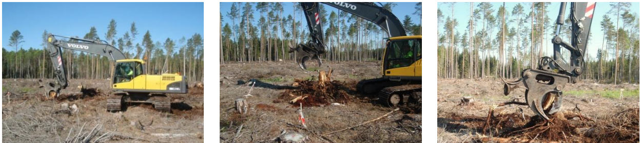
Figur 1 Vid stubbskörd används en maskin med ett särskilt gripaggregat som drar upp stubben ur marken. Stubben skakas sedan för att bli av med en så stor mängd jord och stenar som möjligt. Stubben klyvs sedan antingen vid själva brytningen eller därefter för att sedan läggas på hög för torkning innan den flisas för förbränning. Foto: Patrik Vestin
