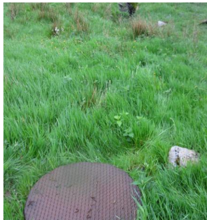
Figur 7. Dräneringsbrunn/rör vid deponins östra kant, beläget i ett kärr (Enström, 2014).
