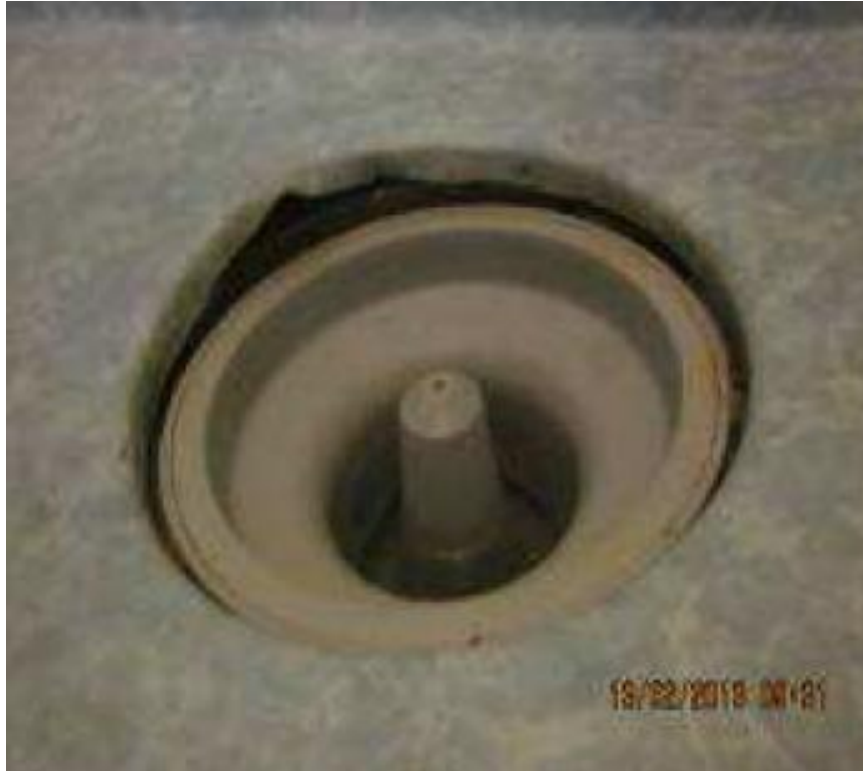
Figur 15: Ålderspåverkan på plastmatta (Länsförsäkringar Skåne 2013)
