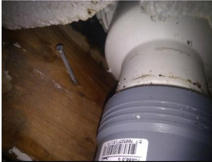
Figur 22: Avloppsanslutning ej fackmannamässigt utförd (Länsförsäkringar Skåne 2011)
