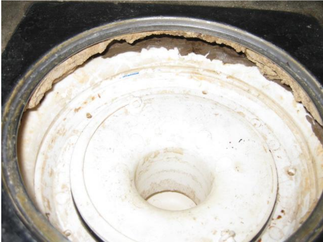
Figur 14: Brunnsmanschett och klämring saknas (Länsförsäkringar Skåne 2011)
