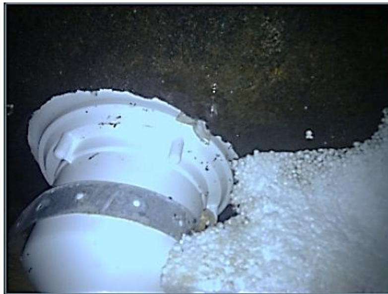
Figur 23: Blöt spånskiva där vatten droppar ner i krypgrund (Länsförsäkringar Skåne 2011)
