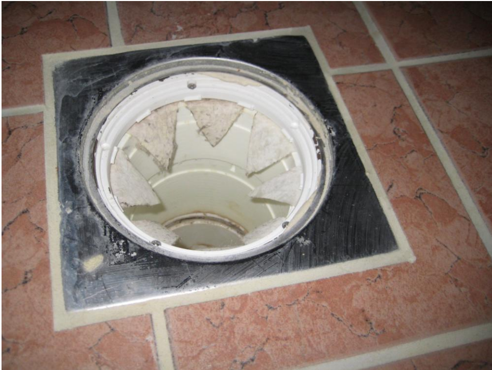
Figur 21: Felaktigt utfört tätskikt (Länsförsäkringar Skåne 2009)
