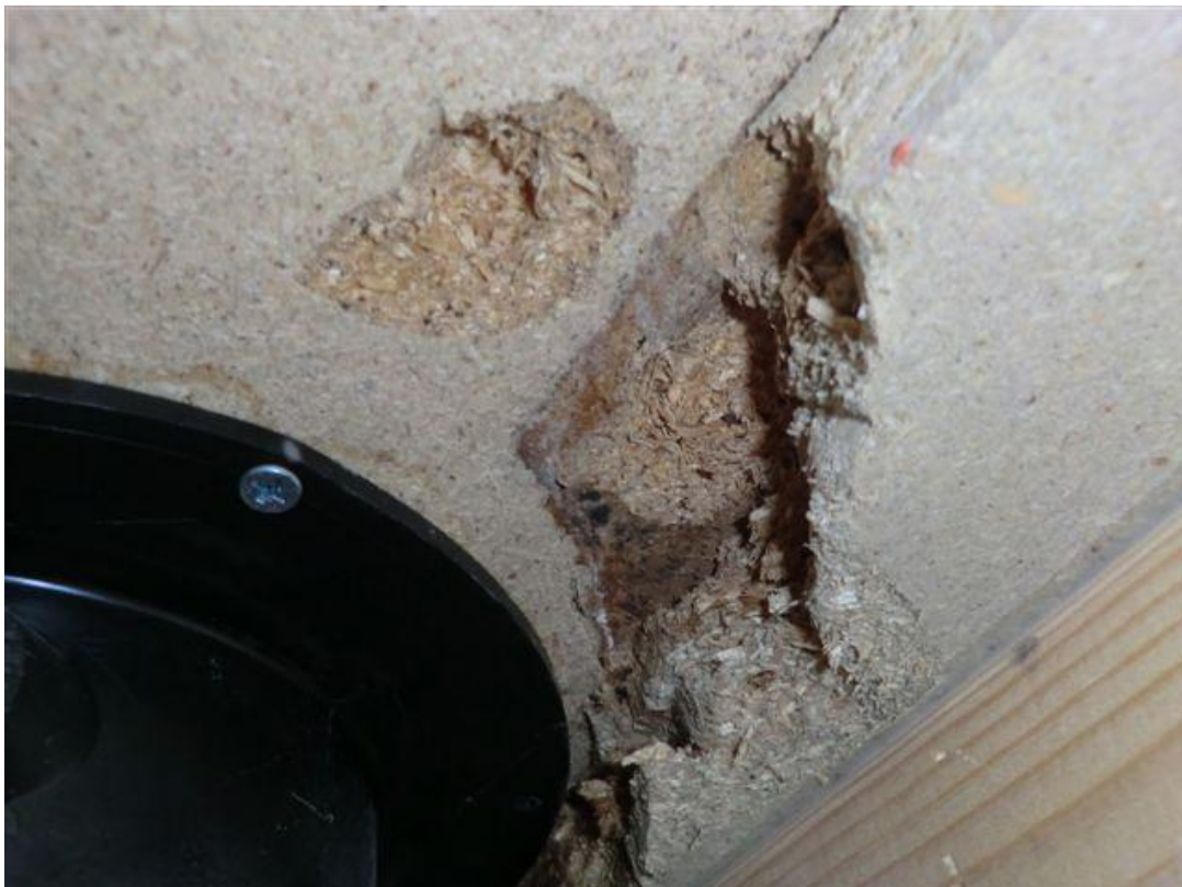
Figur 16: Felmontering och endast fäst underifrån i spånskivan (Länsförsäkringar Skåne 2011)
