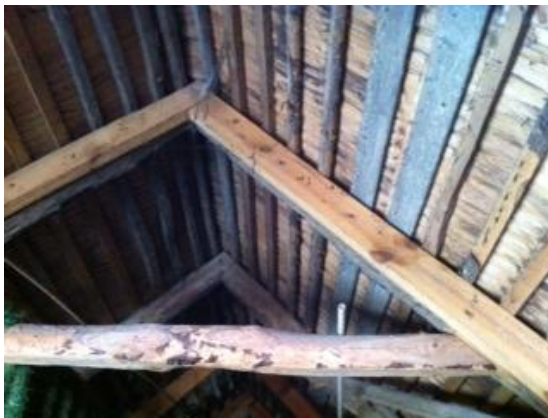
Figur 2.11 (Foto A.Månsson) Yttertaket sett inifrån vinden med takspånen som ligger spikade ovanpå en bärläkt.
