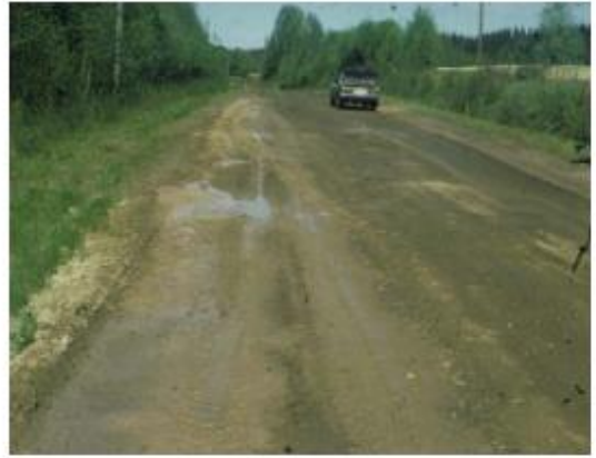
Stående vatten på körbanan
