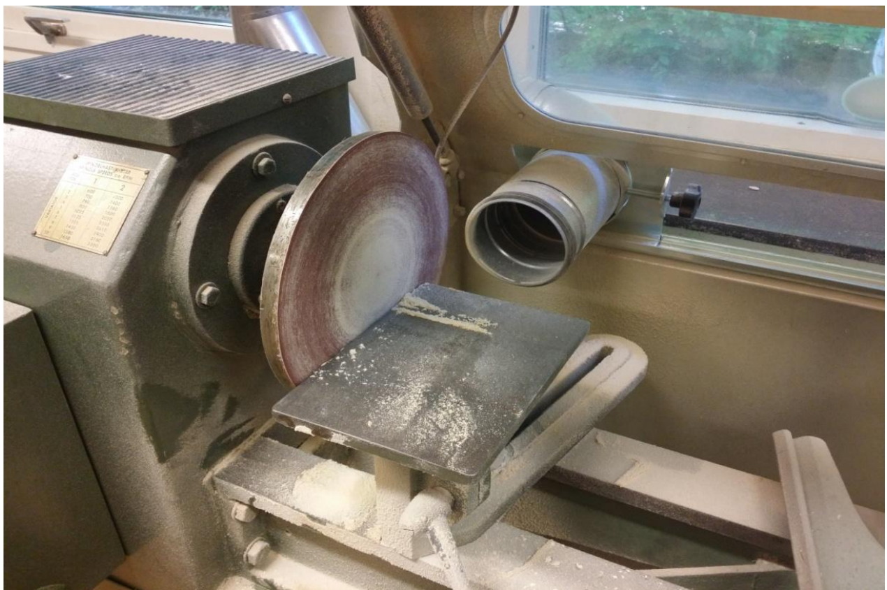
Figur 2.6 Punktutsug vid slipmaskin i träslöjdsalen på Tunaskolan.
