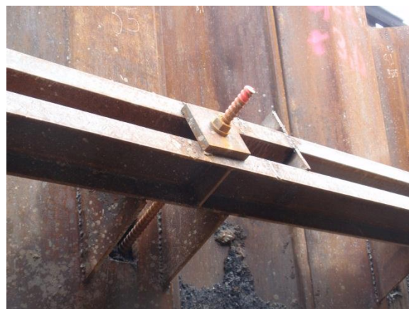
Figur 2. Självborrande stag, monterat i ett hammarband på en tätspont (FOTO: Jonas Nilsson).
