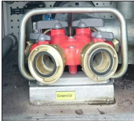
Figur 5. Grenrör som kan orsaka tryckförluster genom att vatten kolliderar med väggar och andra vattenstrålar, varpå turbulens skapas.
