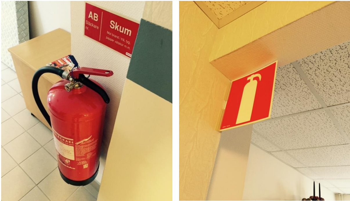
Figur 5.1. Skumsläckare i korridor och exempel på skyltning. Fotografi: Gustaf Berglund.
