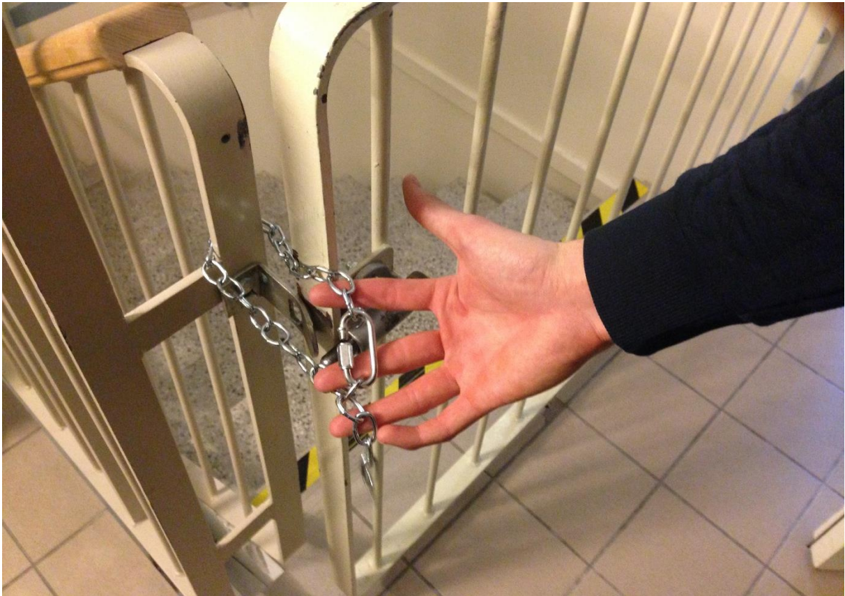
Figur 4.4. Kedjeregeln på grinden strider troligen mot bestämmelserna i AFS 2009:3. Fotografi: Martin Thomasson.
