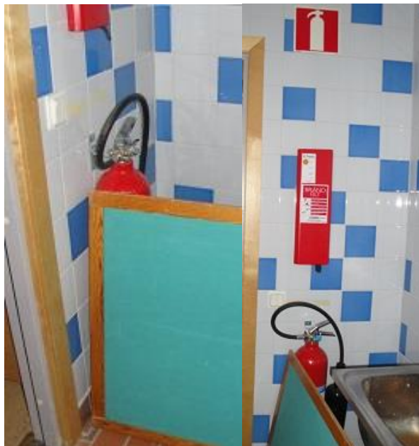
Figur 5-2 Bilderna ovan visar en blockerad kolsyresläckare i en av slöjdsalarna. Bild: Sofia Majtorp.
