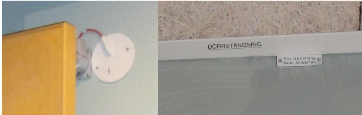
Figur 4-1 Till vänster: Figuren visar de magnetiska dörrstängare som används. Till höger: En av de dörrstängningsknappar som finns monterade under innertaket. Bild: Sofia Majtorp.
