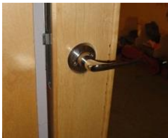
Figur 5-3 Bilden visar en av de dörrar som inte gick igen då dörrstängningen testades. Bild: Sofia Majtorp.
