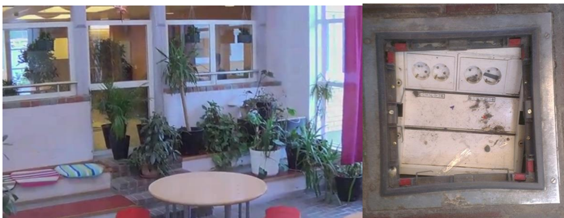
Figur 6-5 Till vänster: Glasatriet. Bild: Sofia Majtorp. Till höger: Eluttagen i atriet har utsatts för mycket slitage och smuts. Bild: Nerma Hajic.
