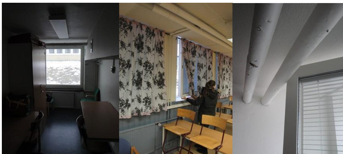
Figur 5-1 Bilderna visar bristerna vid fönsterutrymning för källarklassrummet i byggnad A. Bild: Sofia Majtorp.
