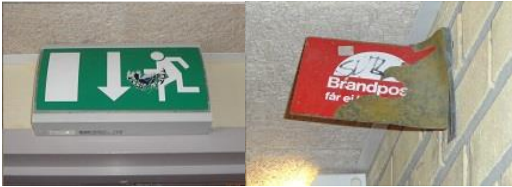
Figur 5-5 Trasig skyltning i byggnad C. Bild: Sofia Majtorp.
