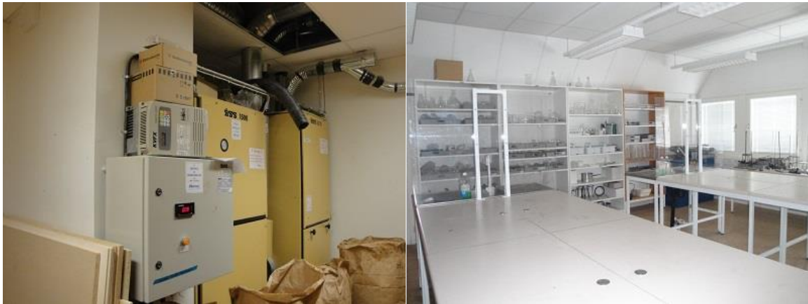
Figur 2-12 Till vänster: Träflissugen i träslöjdsförrådet. Till höger: Kemisal. Bild: Sofia Majtorp.
