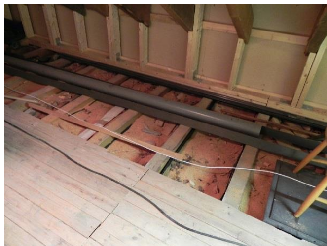
Bild 9. Sågspån i bjälklag. (Platsbesök 19/2-2014)
