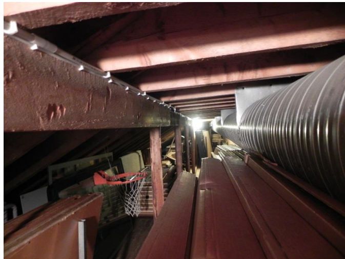
Bild 5. Förvaring i utrymmet under södra läktaren i idrottshallen. (Platsbesök 19/2-2014)
