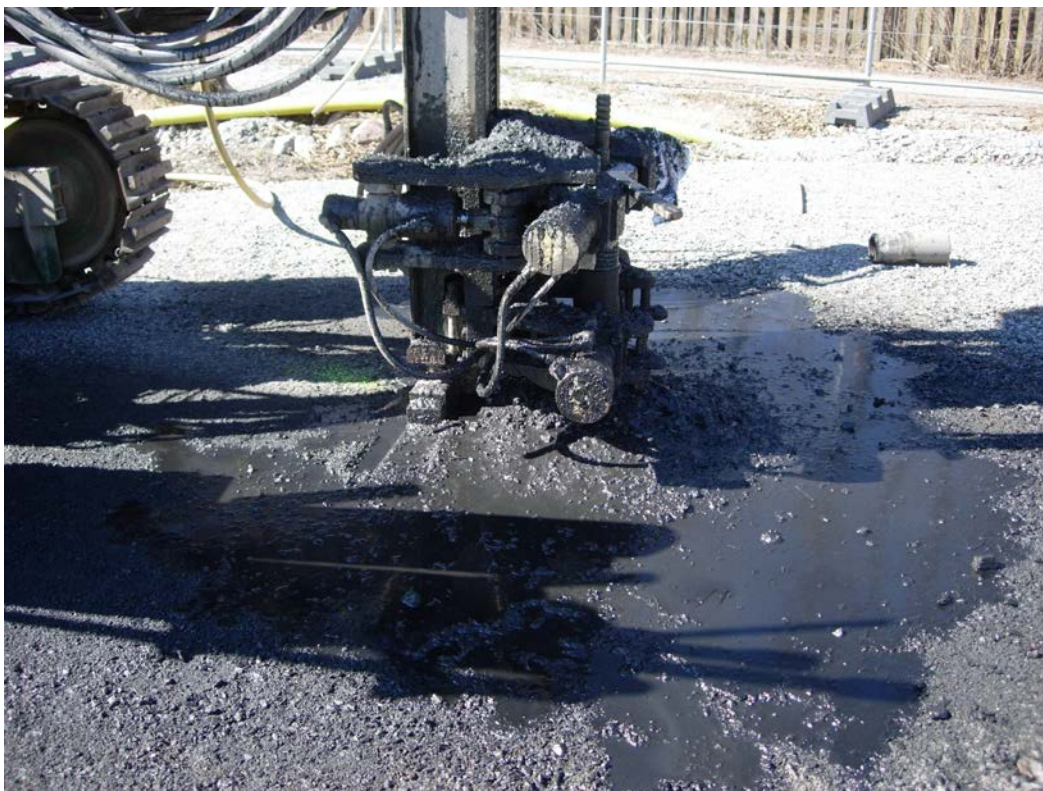
Figur 23: Kraftig lukt av lösningsmedel och petroleum i grundvattennet i JB-sonderingspunkt 10GA102.
