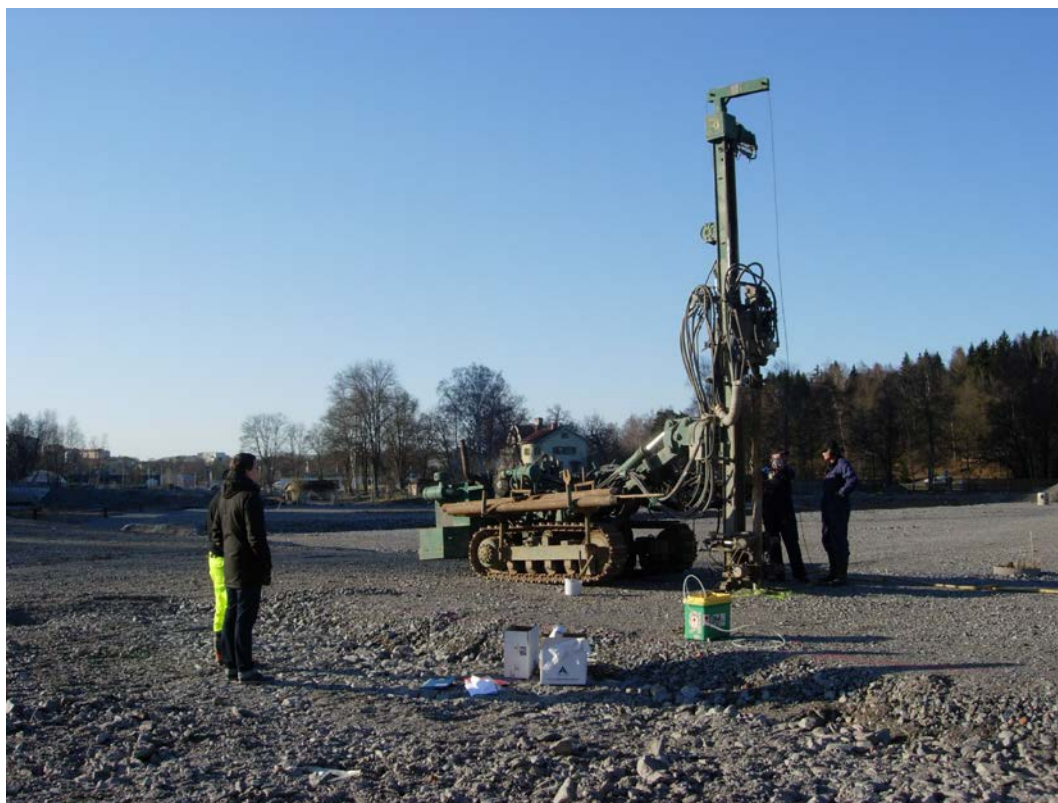
Figur 22: Borrbandvagn för sondering, rördrivning och provtagning, här vid grundvattenrörinstallation i punkten 10GA106. Borrbandvagnen var av modellen Klemm, vilken är den största borrbandvagnen för borrhning i blockiga grovkorniga jordlager.
