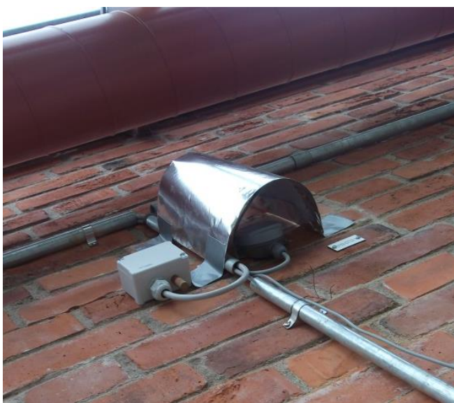
Figur 35 - Givare i glasfasaden med monterad solavskärmning.
