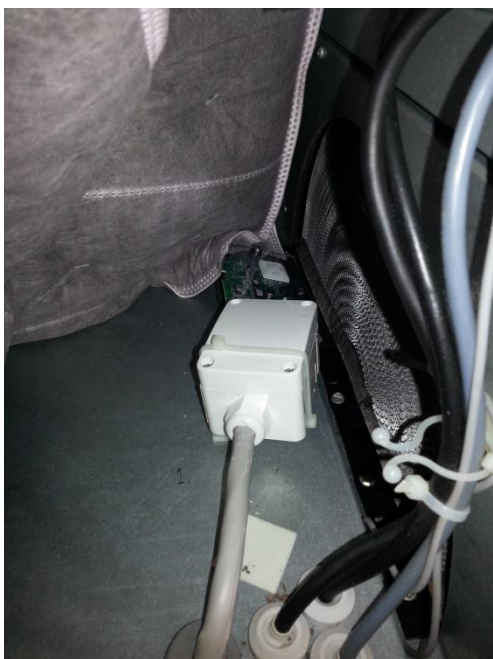
Figur 24 - Placering av egen öppen logger samt befintlig givare (5701-GT11) i ventilationsaggregatet.
