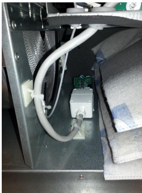
Figur 25 - Placering av egen öppen logger samt befintlig givare (5701-GT21) i ventilationsaggregatet.
