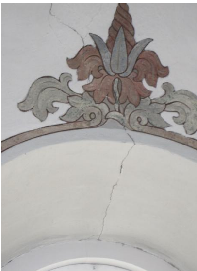
Figur 20 Sprickor i fönstervalv
