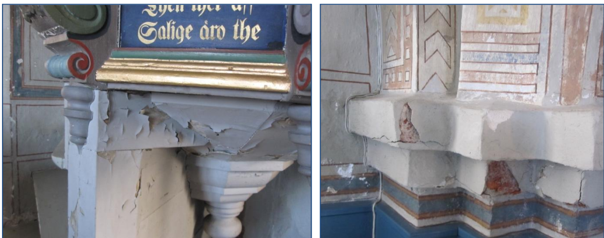
Figur 2 Flagnande färg på trä, predikstolen i Starby. Samt mekaniska skador på murverket i Starby
