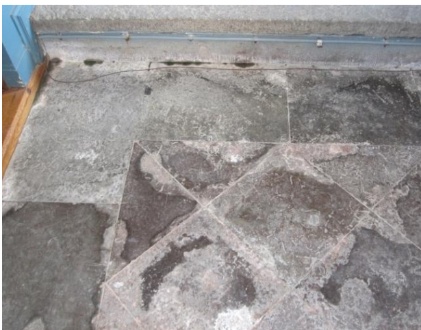
Figur 17 Vittringsskador och saltutfällning på golvet
