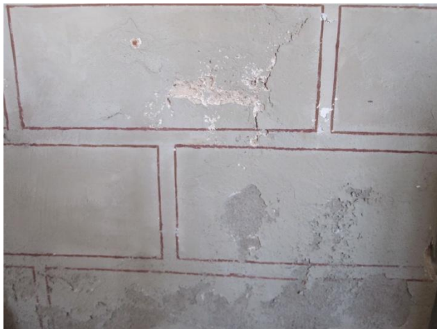
Figur 16 Skador på insidan av ytterväggen
