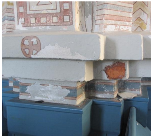
Figur 15 Skador på valvpelare
