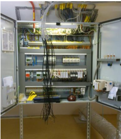
Bild 2.3.4:2 Apparatsskåp med PLC i ventilationsrummet.
