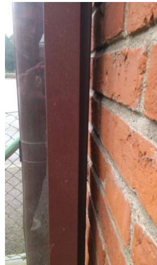
Bild 2.3.4.2:2 Springa för luftintag till glasfasad
