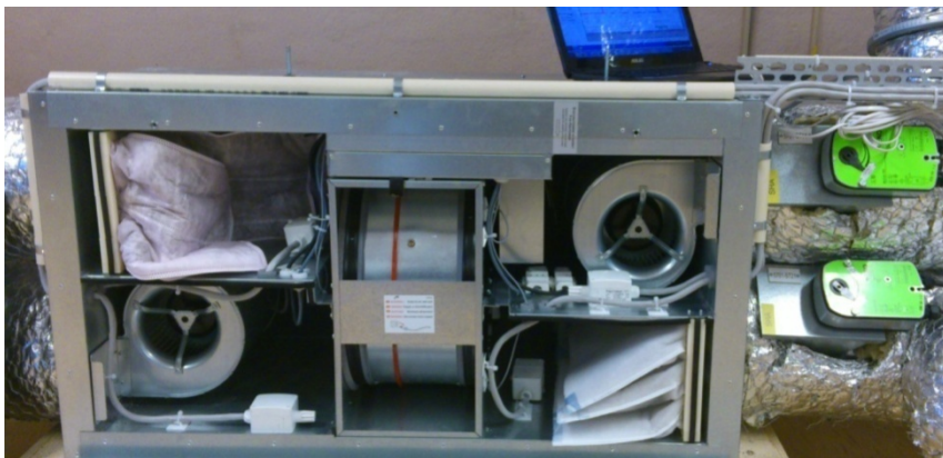
Bild 7:4 Ventilationsaggregatet i närbild
