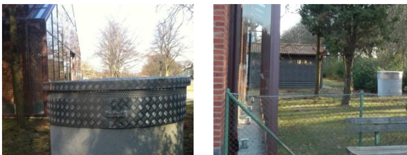
Bild 2.3.4.2:3 Bilden till vänster visar luftintag till markkanal, Bilden till höger visar lufttillförseln från markkanalen till glasfasaden i marknivå.
