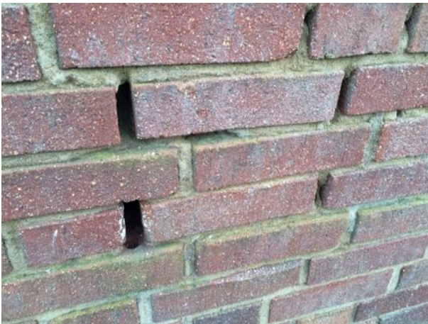
Figur 3.9: Fogar i bärande tegelvägg (Fotograf: R. Friberg).
