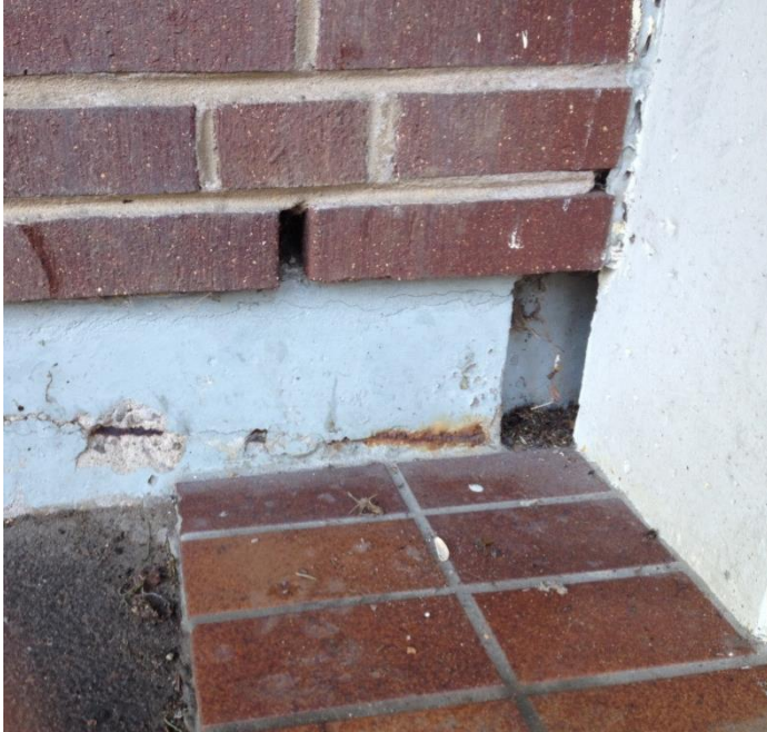
Figur 3.10: Armeringskorrosion i grundmur (Fotograf: V. Karlin).
