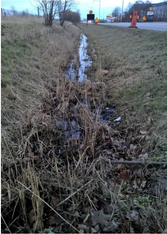
Figur 3: Dike i stort behov av underhåll.
