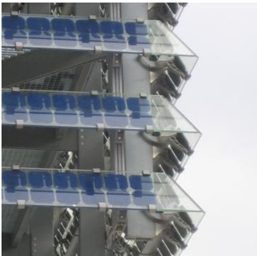
Figur 3.10 Byggnadsintegrerade solceller – solskydd (van Noord, 2010)
