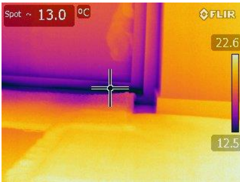
Figur 10. Nederkant balkongdörr, vardagsrum.
