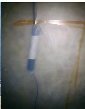
Figur 9. Sensor bakom plastfolien i takkonstruktionen.
