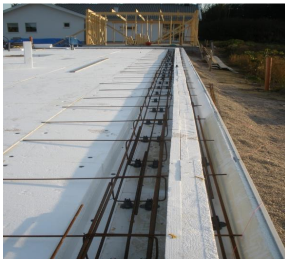
Figur 19. Bygelarmeringen (d=8 mm) skär igenom den inre stående delen av u-et på ett c/c avstånd av 600 mm.
