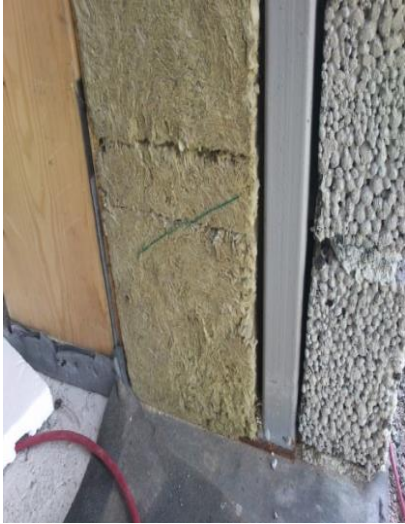
Figur 7. I figuren syns tydligt väggens olika skikt, förutom installationsspalten och de invändiga skikten. VKR-profilen avlastar den ovanliggande lecabalken.
