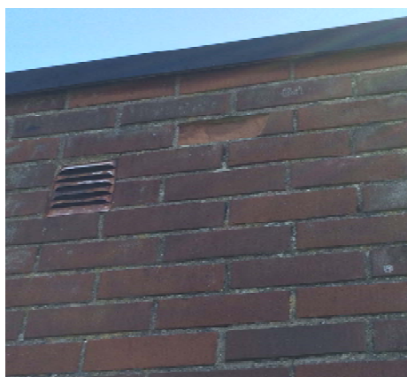
Figur 4.14 Tegel som flisar sig pga. frostsador, Holländarehusvägen 5.
