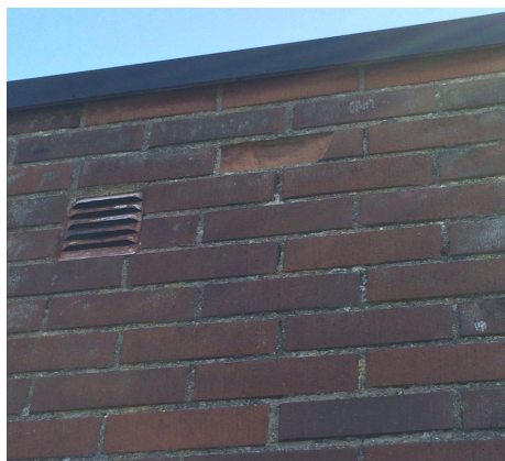
Figur 4.14 Tegel som flisar sig pga. frostsador, Holländarehusvägen 5.
