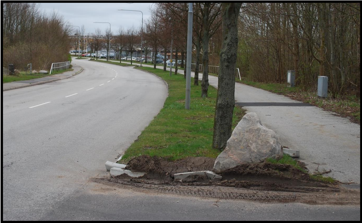
Figur 5.5. Körskador på vägkanter från vinterväghållning Källa: Gatukontoret Malmö stad
