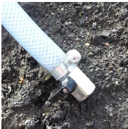
Figur 6 Plastslang med kulventil för manuell öppning och stängning. Foto: Tove Juhl Andersen
