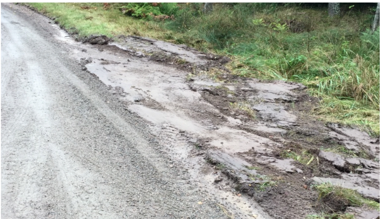
Figur 51: Kanter åtgärdas för att erhålla tillräcklig vattenavrinning. Foto: Författaren.
