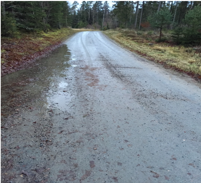
Figur 29: Vattensamling i väggkant. Foto: Författaren.
