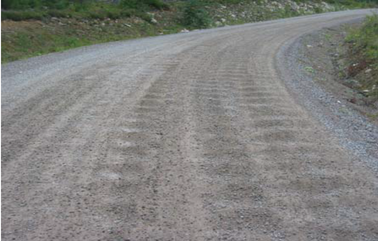
Figur 3: Korrugerad vägyta (Vägverket, 2005).
