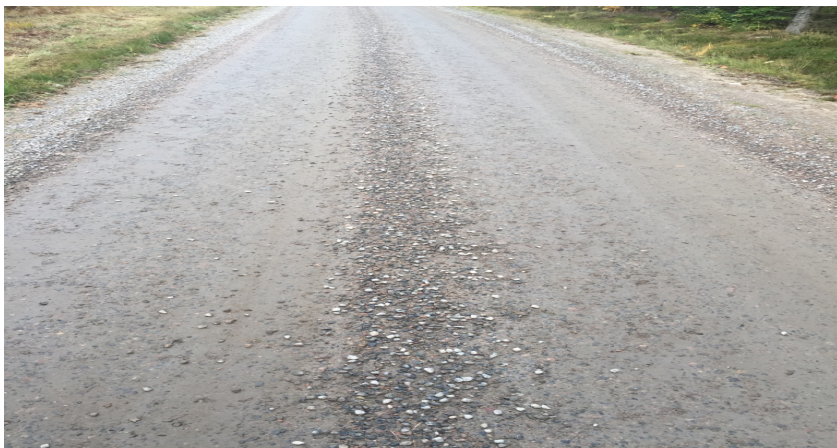
Figur 23: Förekomst av löst grus i mitten av vägbanan. Foto: Författaren.
