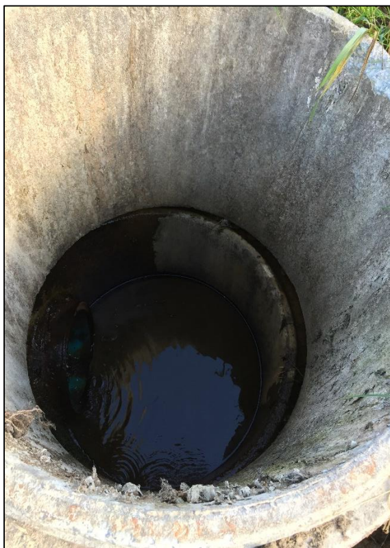
Figur 32: Läckande kupolbrunn, Eslöv 317
