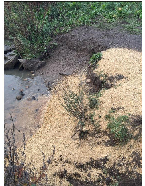
Figur 132: Andutmatning och erosion, Tomelilla 162
