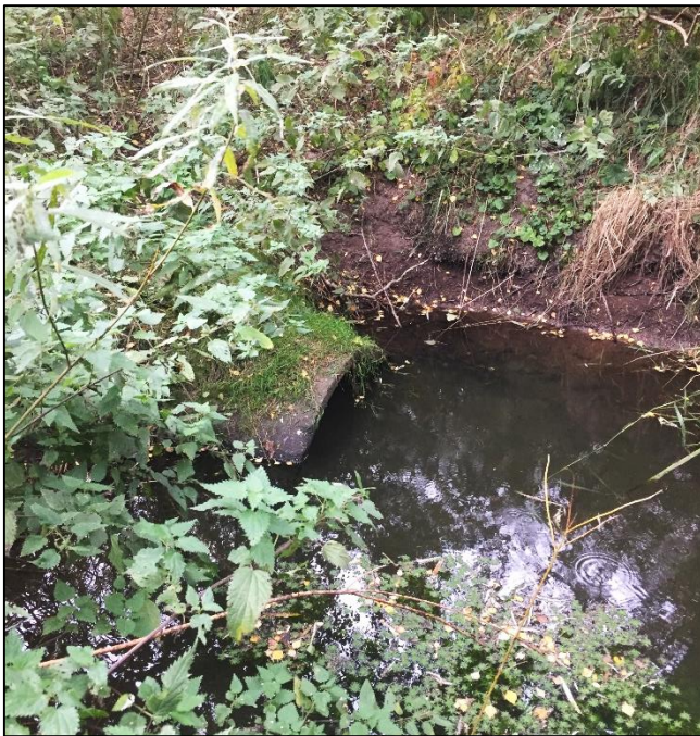
Figur 11: Inlopp och erosion, Eslöv 92B
