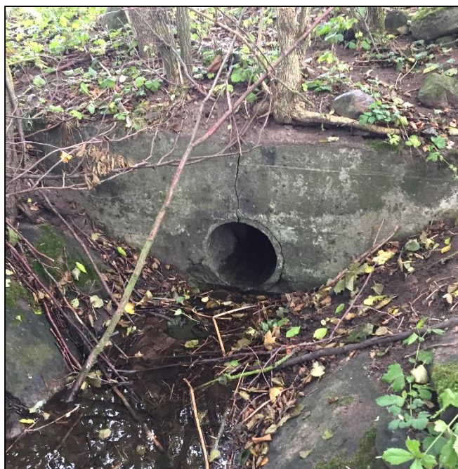
Figur 31: Inlopp & spricka, Eslöv 304
