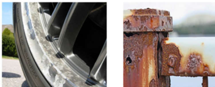
Figur 10 Bild illustrerar hur metallisk korrosion påverkar.
