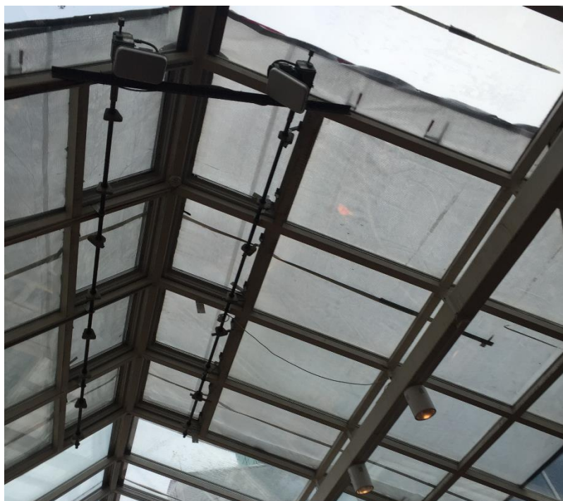
Figur 8. Exempel på brandgasluckor i Gallerian som var övertäckta med presenning.
