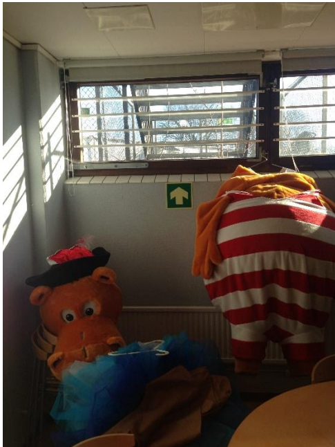
Figur 8 Utrymningsväg via fönster i personalrum
