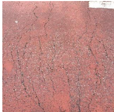
Figur 7. Sprickor i hjulspår (Dockan)
